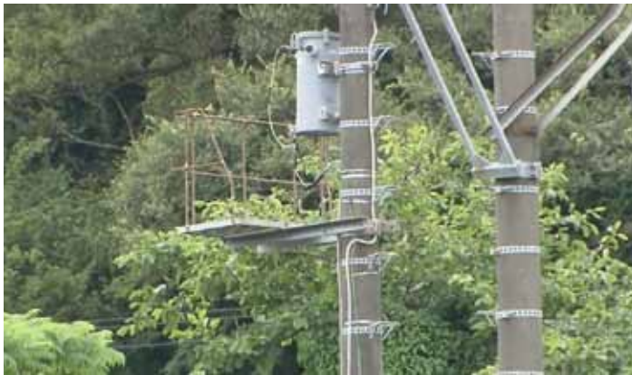
事故は変圧器の部品交換中に起こった
